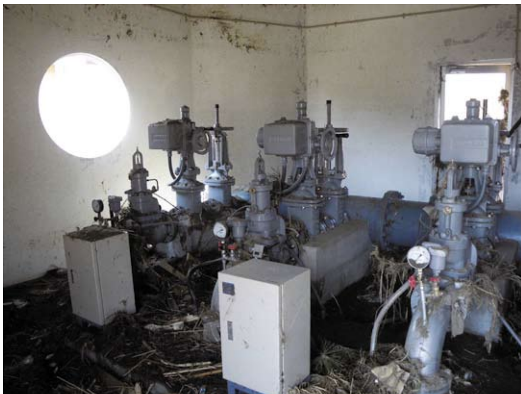
写真岩－1 陸前高田市 竹駒第1水源井戸
