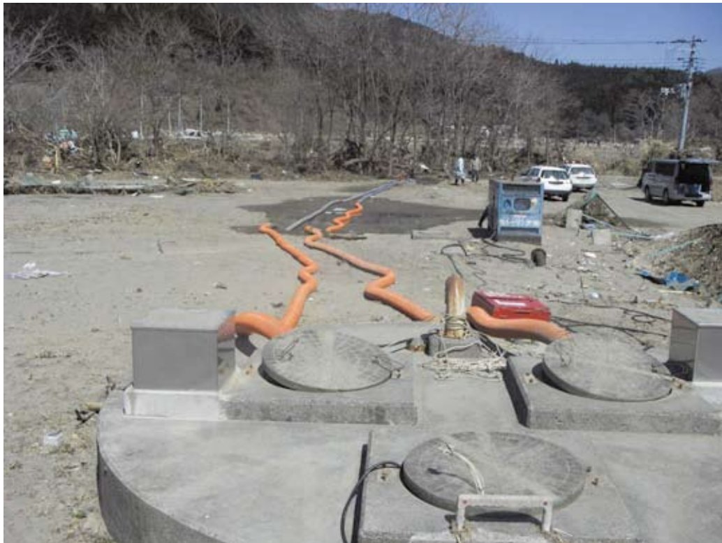
写真岩一 3 陸前高田市 矢作水源井戸
